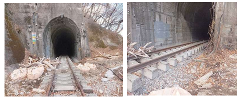
『2019年の台風19号により下り線第9号トンネルが被災』 台風19号の豪雨で中尾川が増水し中尾橋の所であふれ出た水が第9号トンネルに流れ込み、線路のバラストを押し流して、線路が枕木ごと宙に浮いた状態になってしまいました。この状態でも、レールワークも走れません。廃線ワークもトンネルを迂回して実施しております。鉄道が運行されてない廃線なので復旧予算もつかず放置されています。クラウドファンディングに頼るしかないのでは、心細い状態です。 下り線第9号トンネル(軽井沢側)ここから中尾川の水が浸入 トンネル内部ではバラストが流されて枕木が宙に浮いてます
